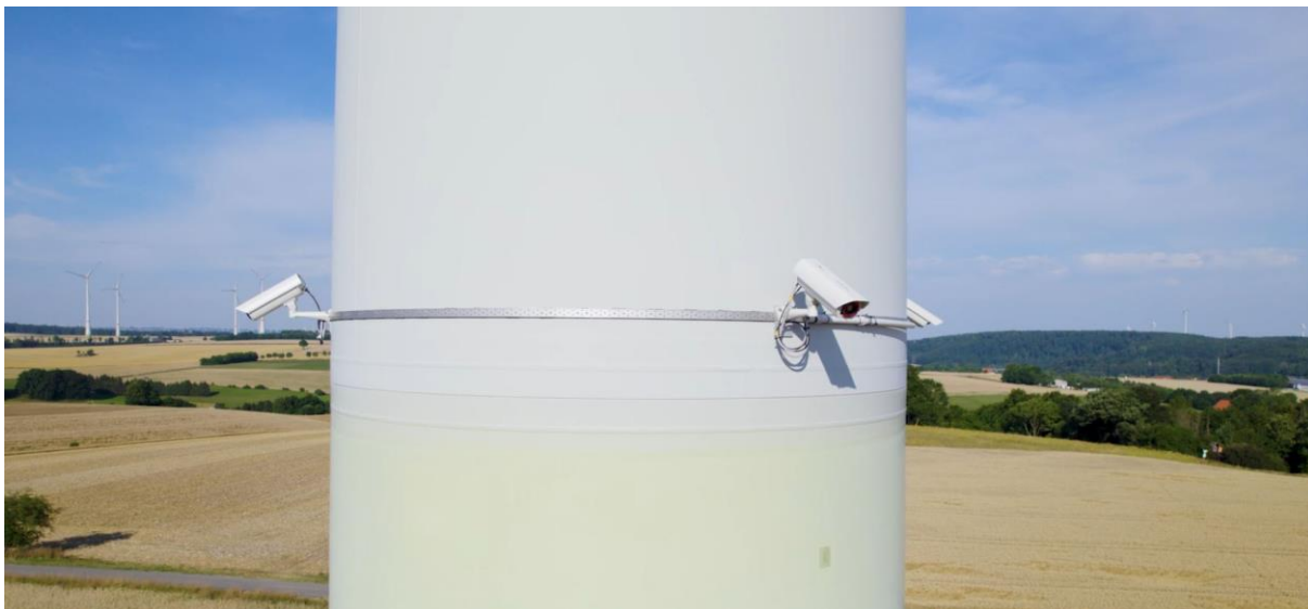
Abb. 1: Am Mast installierte IR-Kameras
